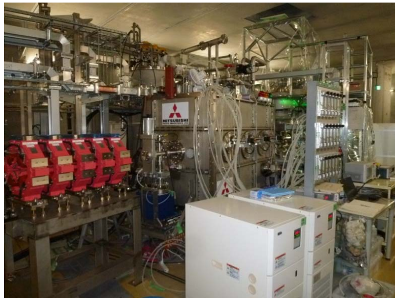
cERLに設置された入射器超伝導空洞Cryomodule
