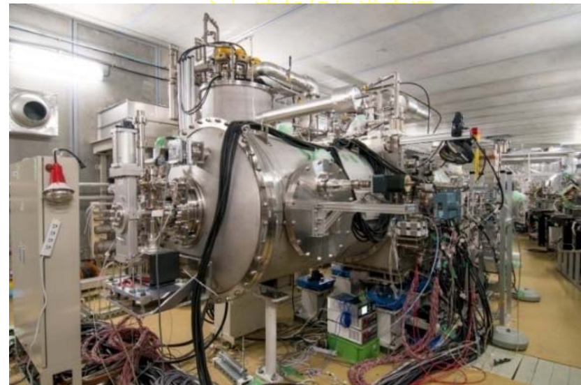
cERLに設置された主加速部超伝導空洞Cryomodule 1
